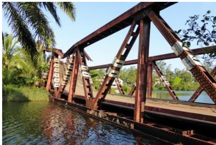
Le pont endommagé, Manakara
